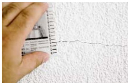
Der Putzriss ist durchgehend im Bereich der ausgeknickten Putzscheibe.
