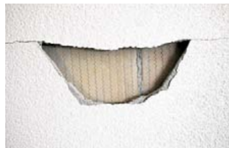
Im Bereich der Ausknickung wurde ein Stück Putz ausgestemmt.
