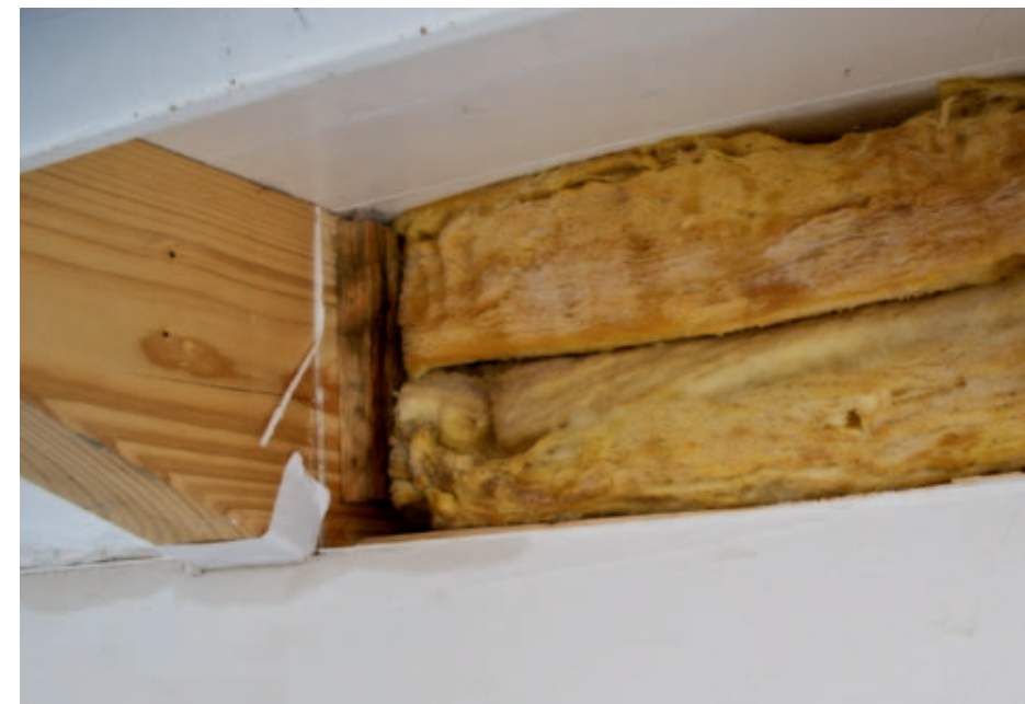
Die Mineralwolldämmung war in einem sehr durchnässten Zustand. Auffallend war auch die Vereisung der Dachuntersicht. Die Bauteilöffnung wurde im Bereich des Stellbretts und der zwei Dämmplatten grossen Öffnung an der Fassade näher begutachtet.
