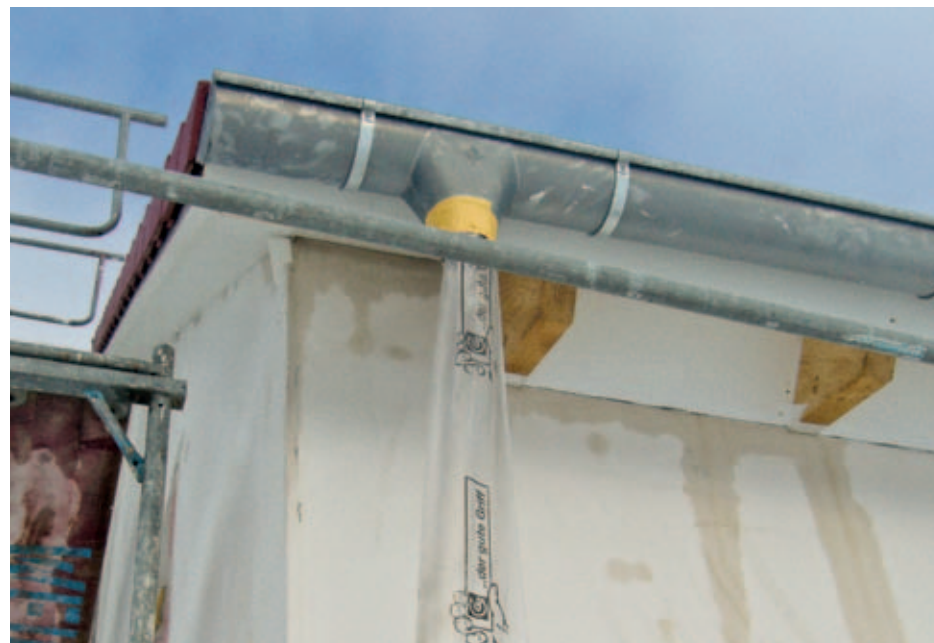
Erheblicher Feuchtigkeitsaustritt durch die Gewebespachtelung.
